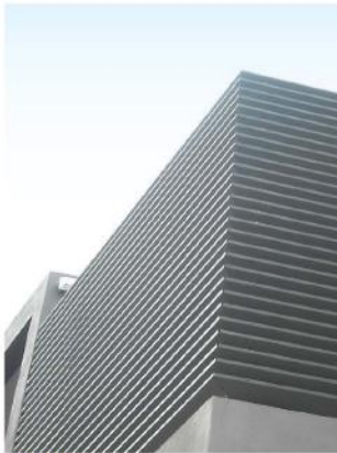
Air Louvers – Ventilation Louvers
