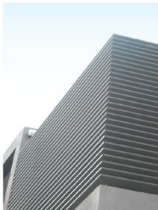
Air Louvers – Ventilation Louvers
